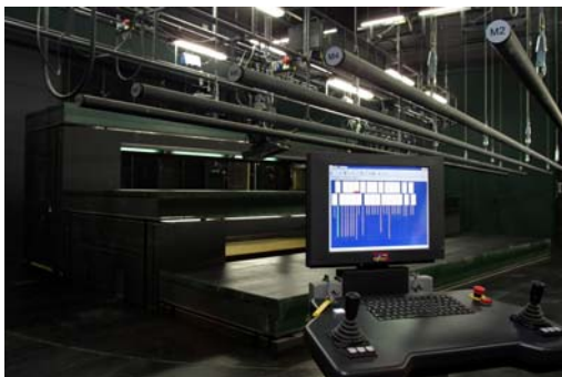
Abbildung 3: Steuerpult vor realen Bühnenelementen: Laststangen
